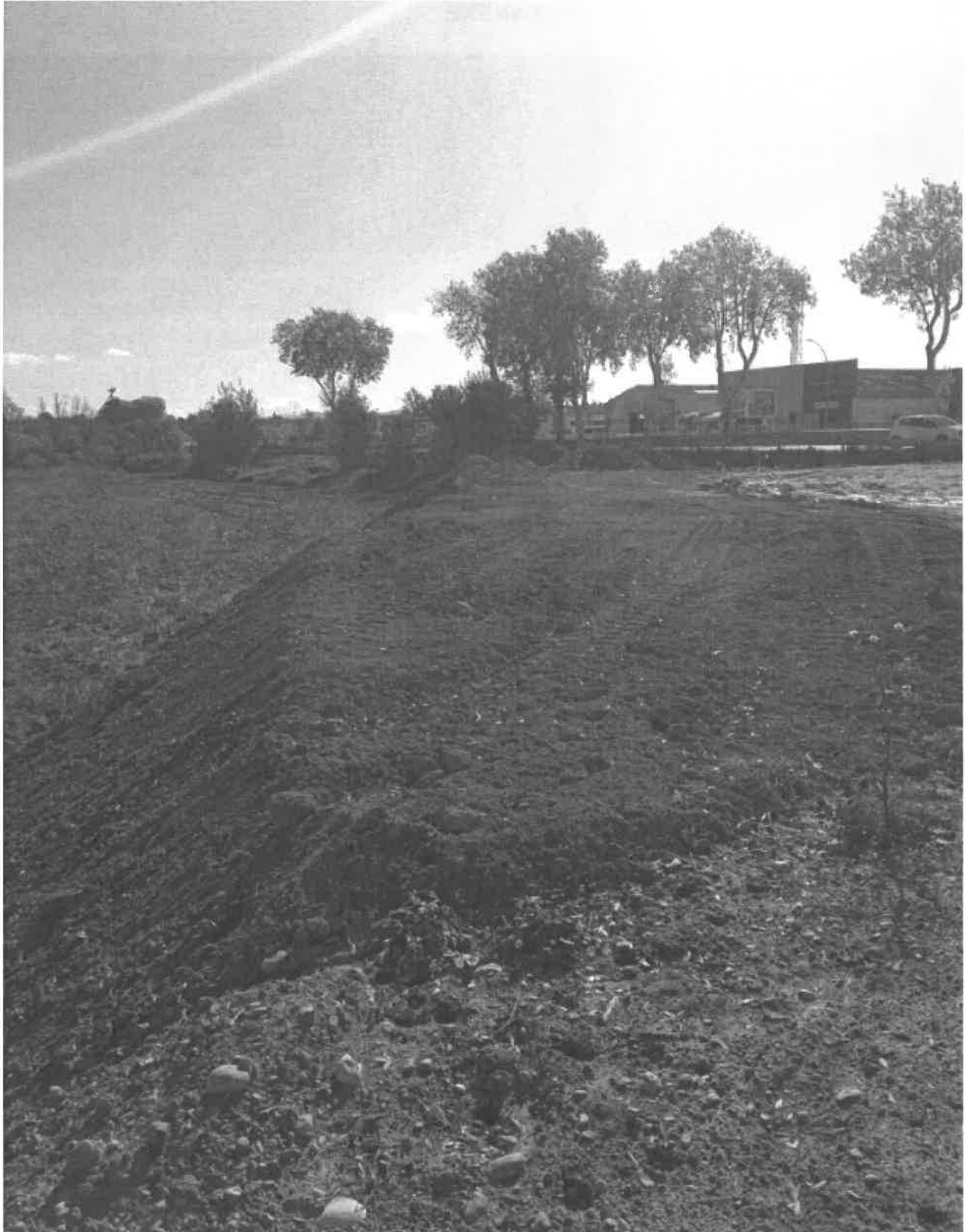
*Remblai de terre (plateforme) et dépôt de matériaux sur la parcelle IX 0007
